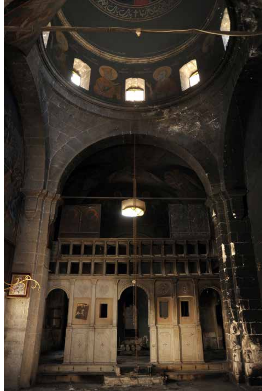
Faraj Chammas, Καταστροφή της Εκκλησίας της Αγίας Θέκλας, Μααλούλα, Συρία, 2014 ● Faraj Chammas, Destruction of the Church of Saint Thekla, Maaloula, Syria, 2014
